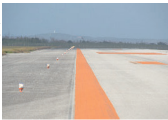
新設された照明
