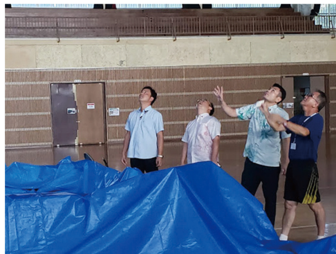
総合体育館の被害を確認
